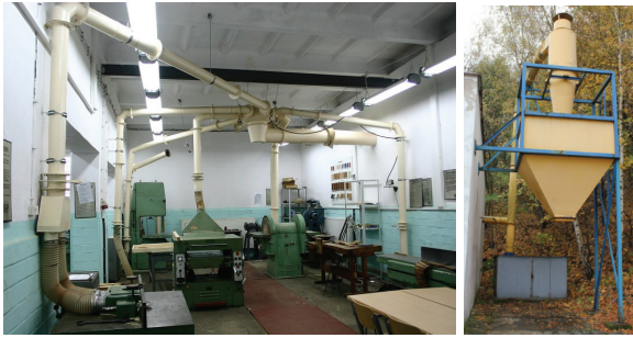
Fig. 2. View of the pneumatic extraction test system Rys. 2. Widok badanej pneumatycznej instalacji odciągowej
